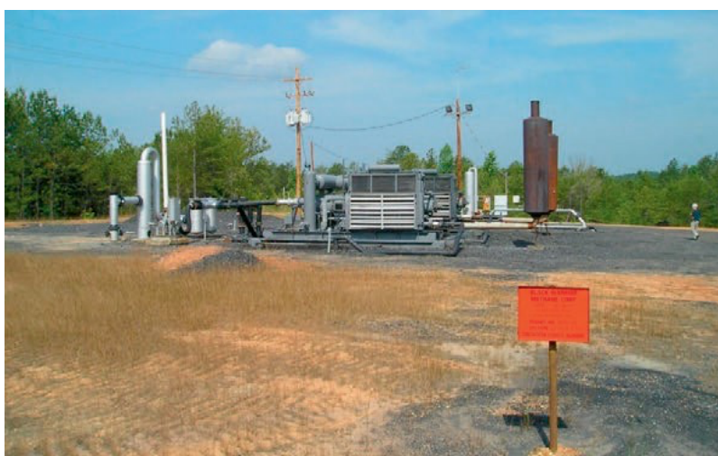
图 1.2 美国阿拉巴马州某在营地地下矿甲烷生产井台
