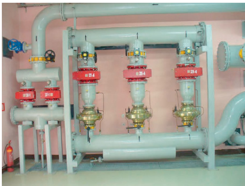
图 4.1 波兰 Pniówek 矿山的瓦斯抽采设备
