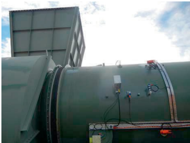
图 3.3 主扇管道上安装实时空气流速监测设备
